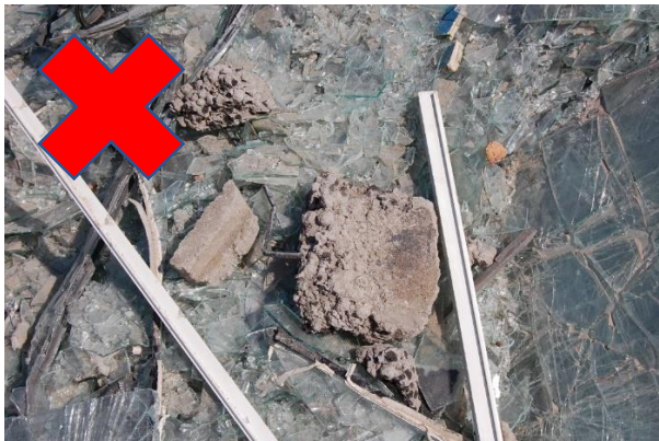
Vervuiling: cement, stenen, strips
