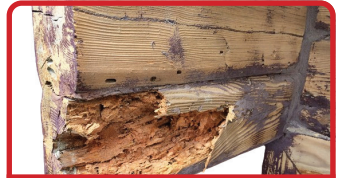
ROTTEND EN SCHIMMELEND HOUT
